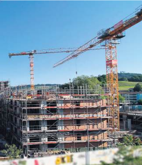
GROSSBAUSTELLE SAN SIRO: Hier kam es zum tragischen Unfall, der Büezer Djavid Veliu das Leben kostete. FOTO: ZVG
