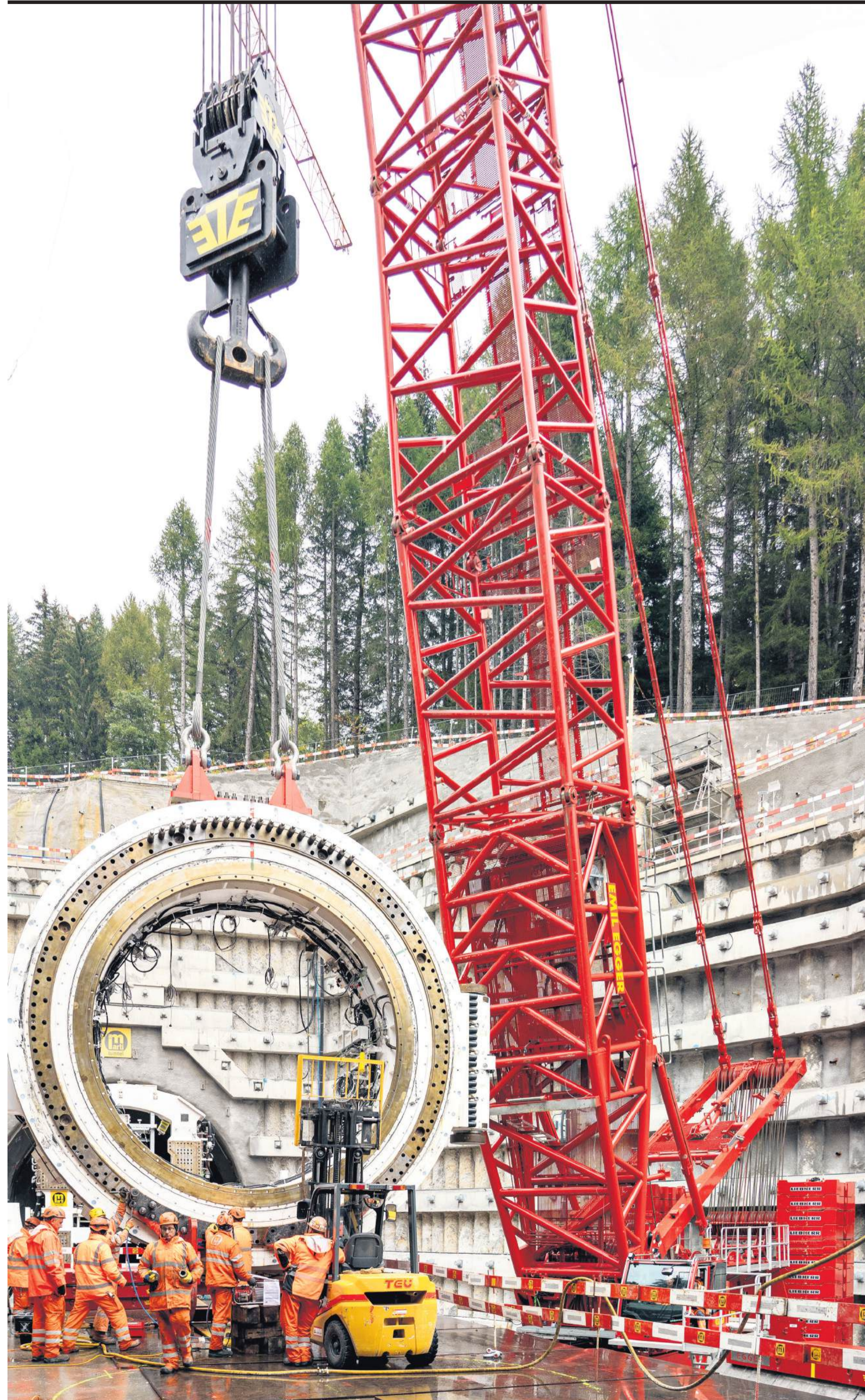
GIGANTISCH: Ein 700 Tonnen schwerer Pneukran hebt ein kreisförmiges Element der künftigen Tunnelbohrmaschine an seinen Platz.
