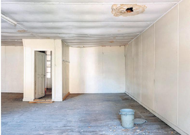
MASSENSCHLAG: In diesem Schlafraum tropft es durch die Decke.
