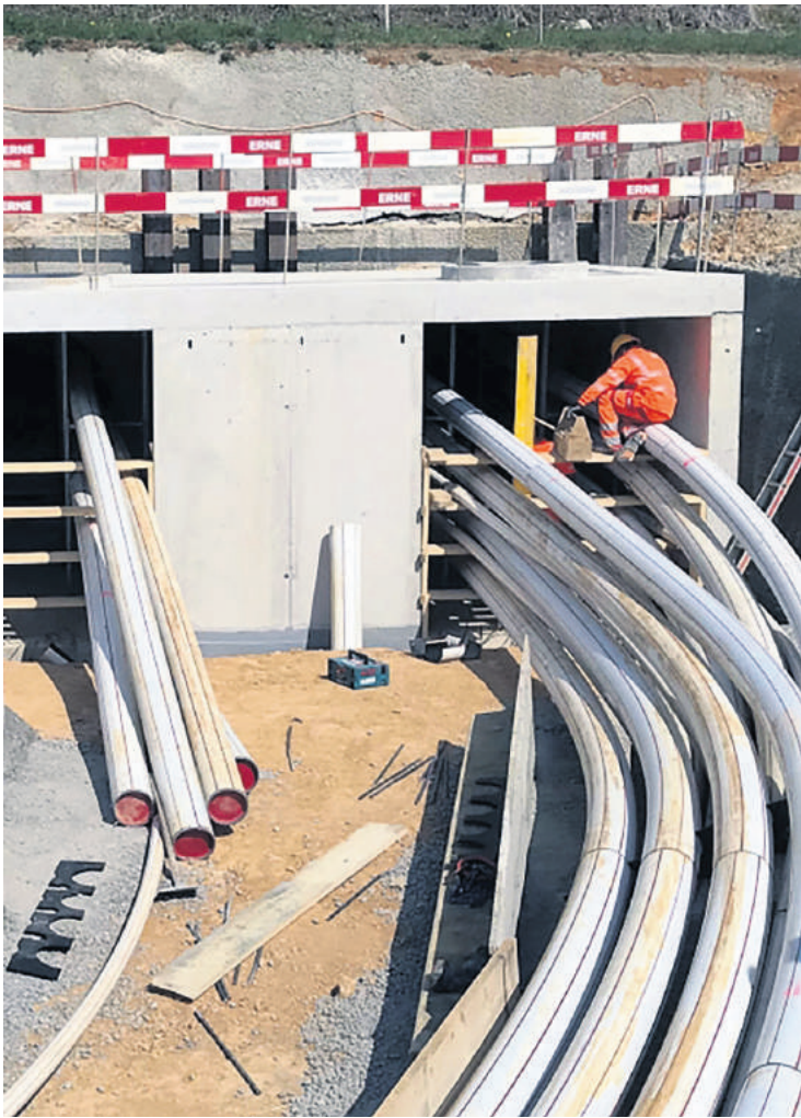
STROM UNTER BODEN: Stromleitungen durch unterirdische Tunnels zu verlegen ist die schlaue Alternative zu oberirdischen Hochspannungsleitungen. FOTO: ENERGIAPLUS
