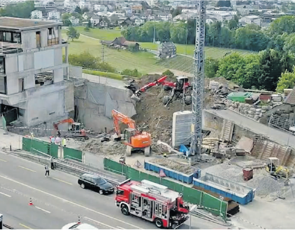
TRAGISCH: Beim Einsturz einer Betonmauer sterben drei Männer auf einer Baustelle in Feusisberg im Kanton Schwyz. FOTO: FILMSTILL SRF
