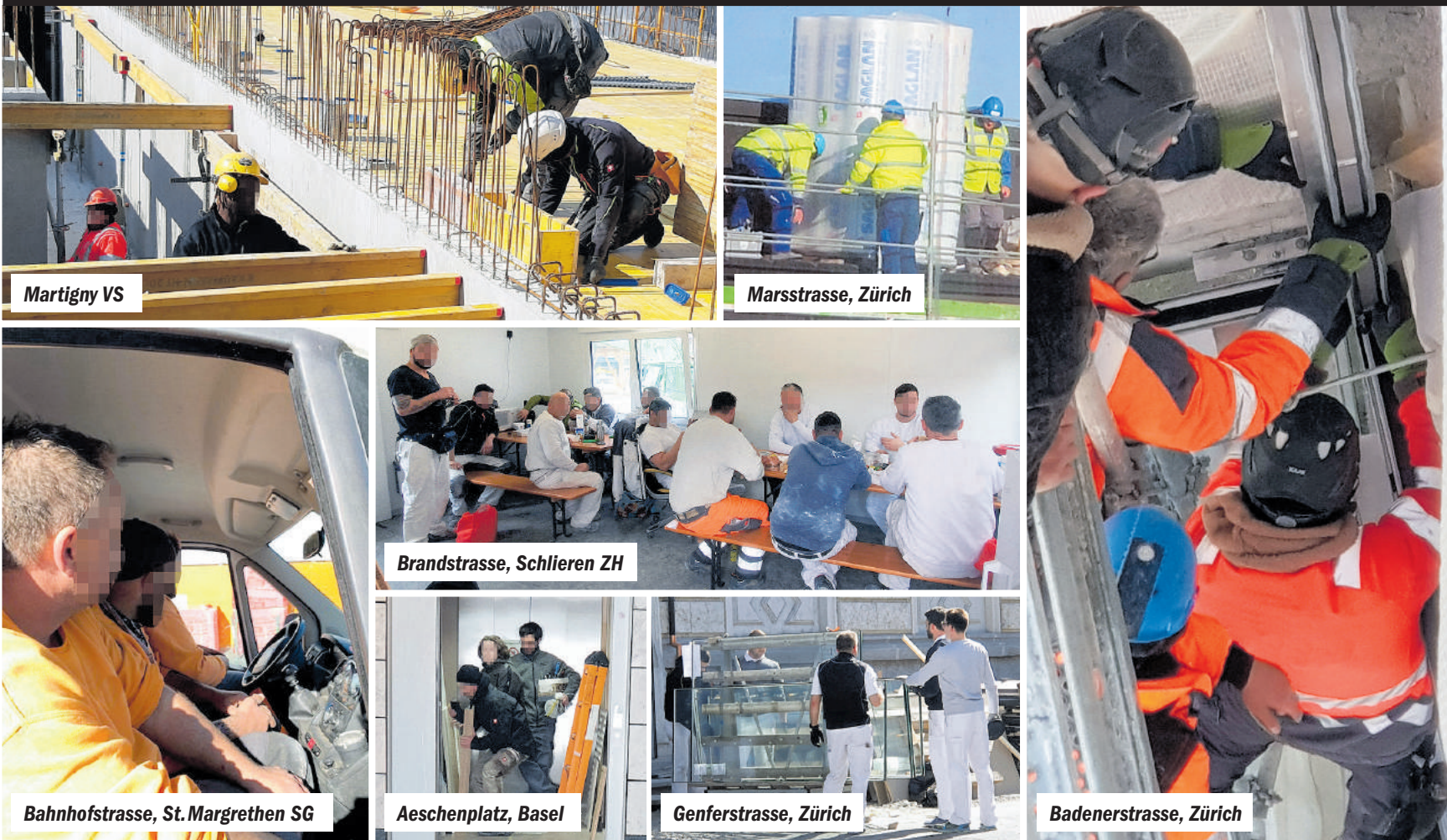
ANSTECKUNGSGEFAHR: Sieben von über 4000 Meldungen von Regelverstössen auf Schweizer Baustellen, die bei der Unia eingegangen sind. FOTOS: ZVG
