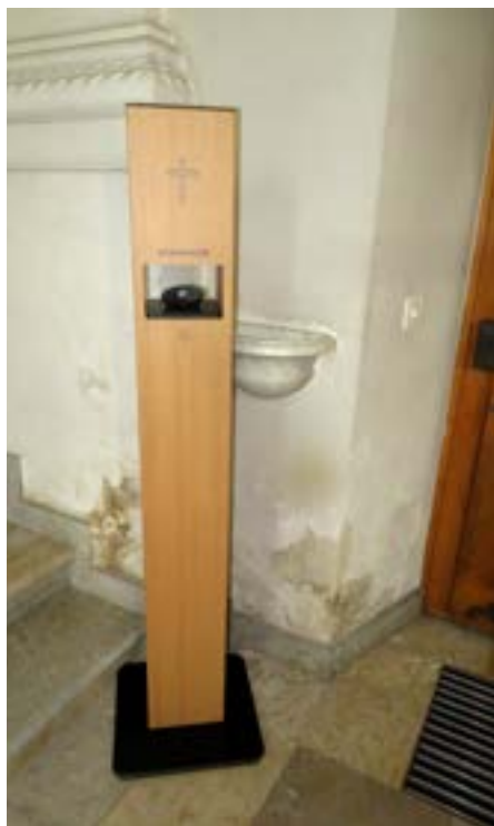
Unübersehbare Schäden im Innern.
