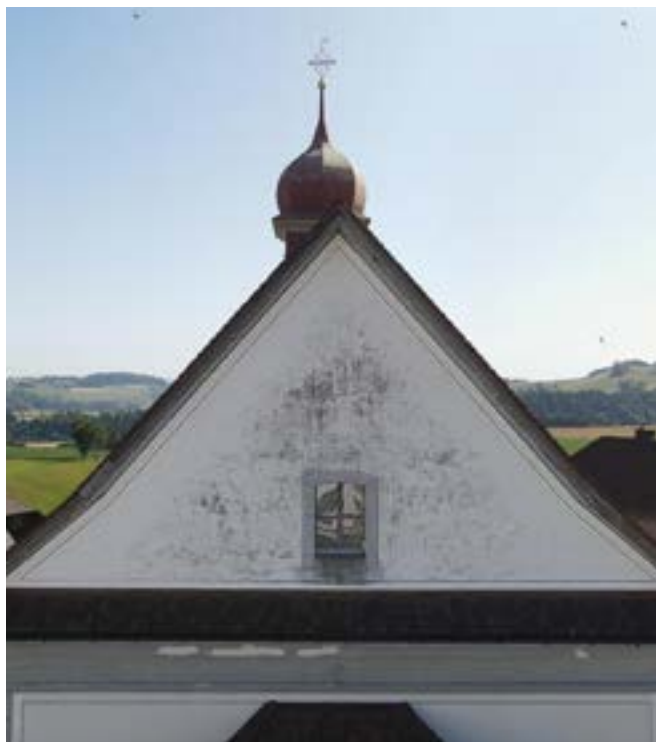
Des dommages bien visibles sur la façade exposée aux intempéries de l'église.
