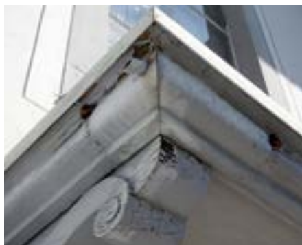
Dommages évidents à l'entrée de l'église.
