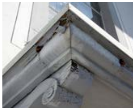
Unübersehbare Schäden an den Kircheneingängen.
