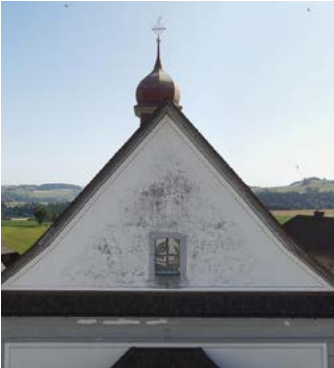
Gut sichtbare Schäden an der Wetterfront der nach Osten ausgerichteten Kirche.
