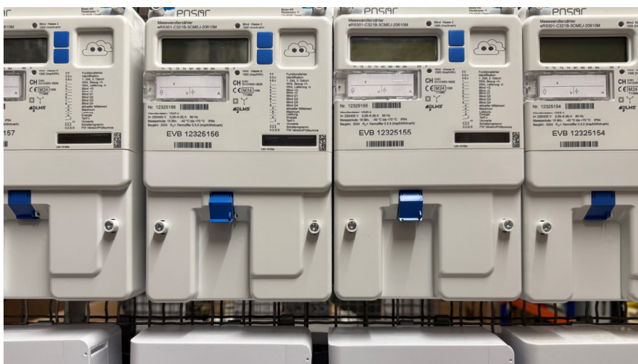
Smart Meter Zähler
