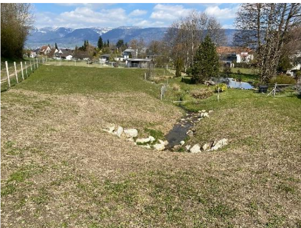
Die EW-Leitung ist unverlegt
