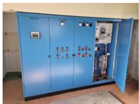
Schaltschrank PW Hägni
