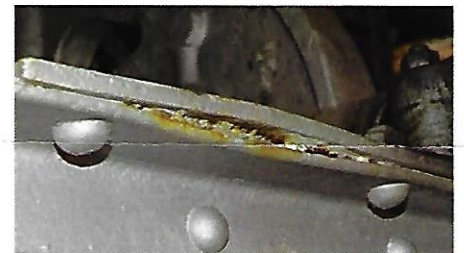
Rostbefall zwischen den Trägern
