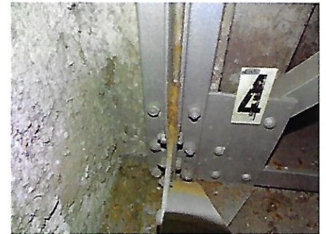
Korrodierte tragende Teile
